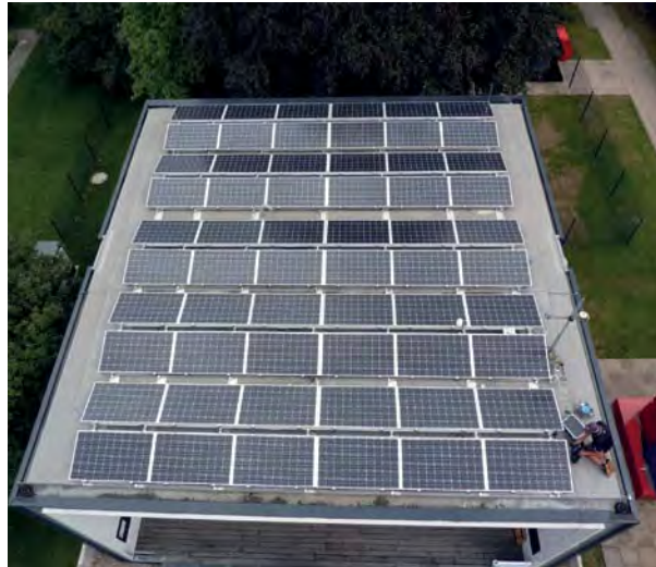
Dachfläche mit monokristallinen Photovoltaikmodulen
